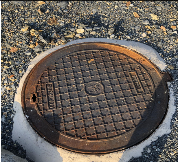
项目污水处排放口与市政污水管网接管处
