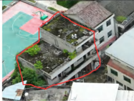
拟拆除危房 1 现状
