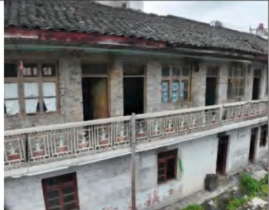
拟拆除危房 2 现状
