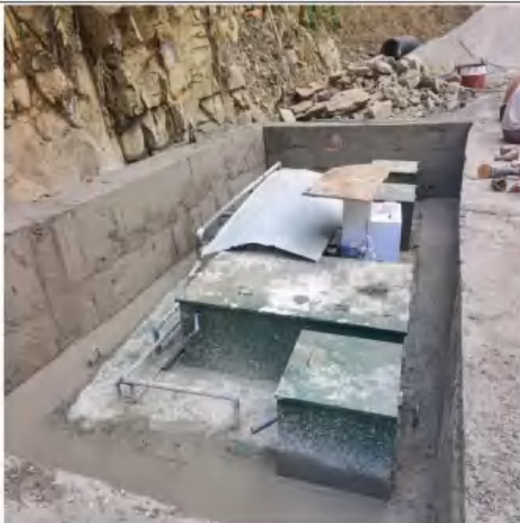
主体探矿工程建设的生活污水处理设施
