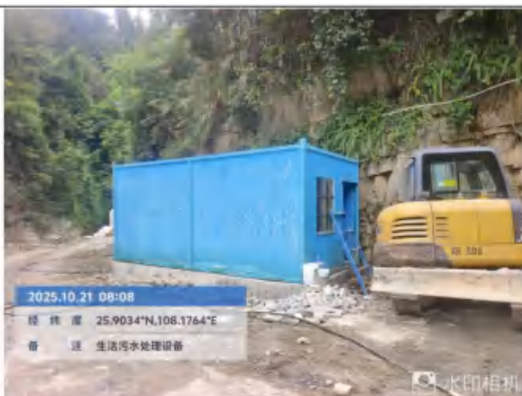
主体探矿工程建设的生活污水处理设施
