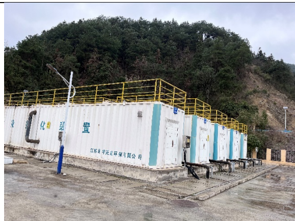
一体化净化装置现场照片
